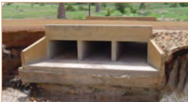
Photo 4 : Menace sur les infrastructures
