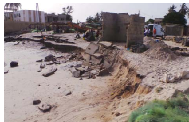
Photo 33 : Dégâts à Bargny en 2014 (1)
