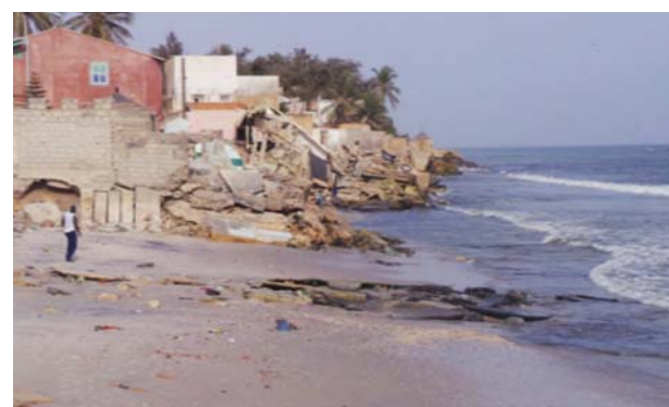
Photo 34 : Dégâts à Bargny en 2014 (2)
