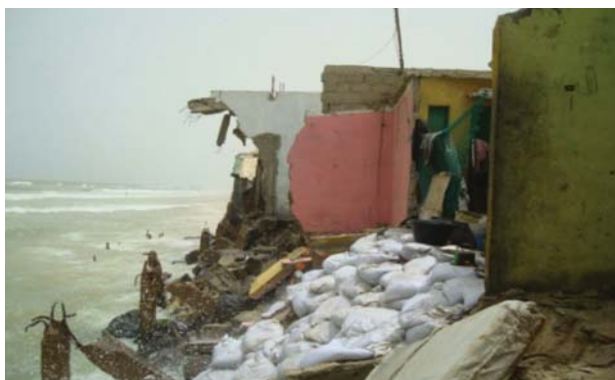
Photo 23 : Dégâts occasionnés par les houles et les vents à Nguet Ndar (Source, DEEC, 2014).
