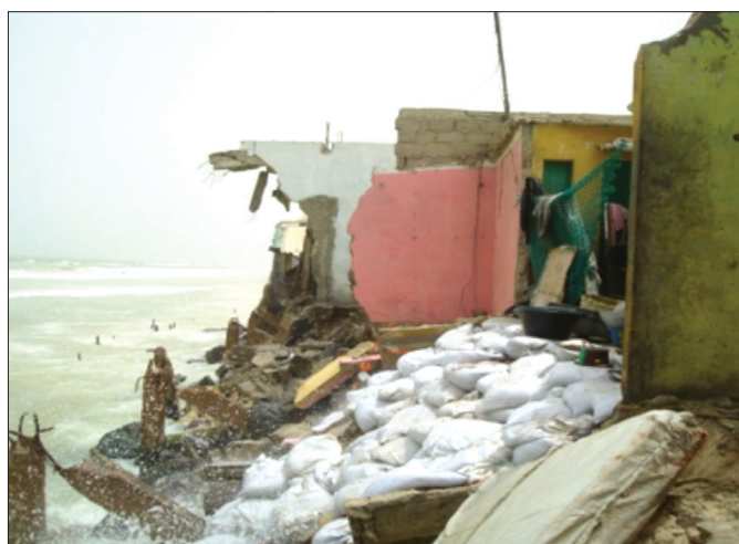
Photo 1 : Dégâts occasionnés par les houles et les vents à Nguet Ndar Source, DEEC, 2014
