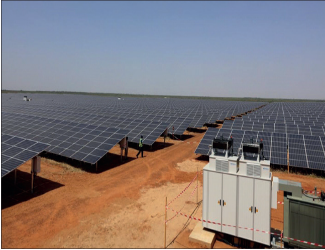
Photo 1 : Centrale photovoltaïque de Bokhol
