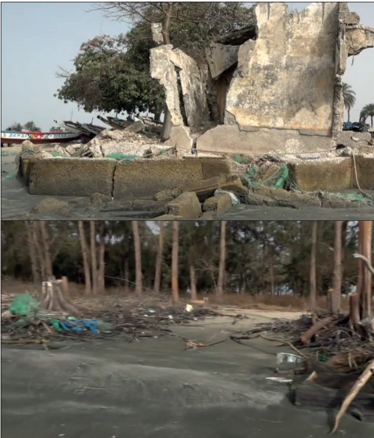
Photos 3 : État de dégradation de l'île de Diogué, le 04 avril 2018
