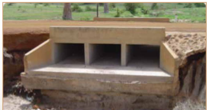
Photo 4 : Menace sur les infrastructures
