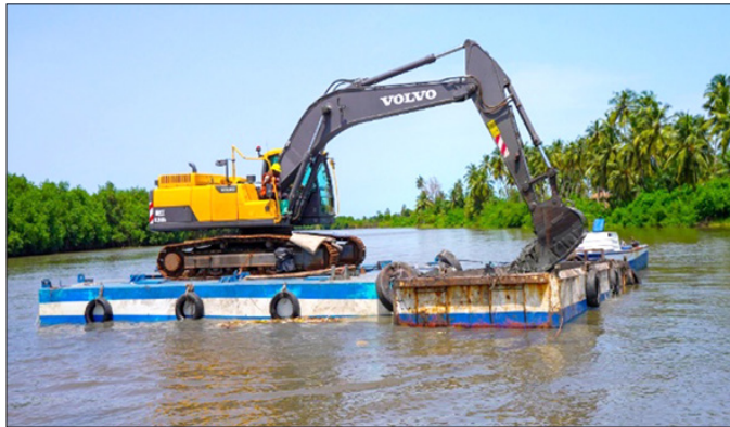
Dragage de sédiments dans le cadre du curage du Chenal Gbaga Dredging of sediments as part of the cleaning of the Gbaga channel
