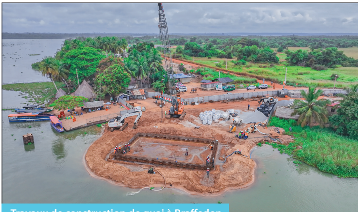
Travaux de construction de quai à Braffedon Quay construction work in Braffedon
